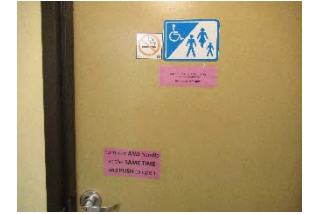
7 EL - Universal washroom - signage
